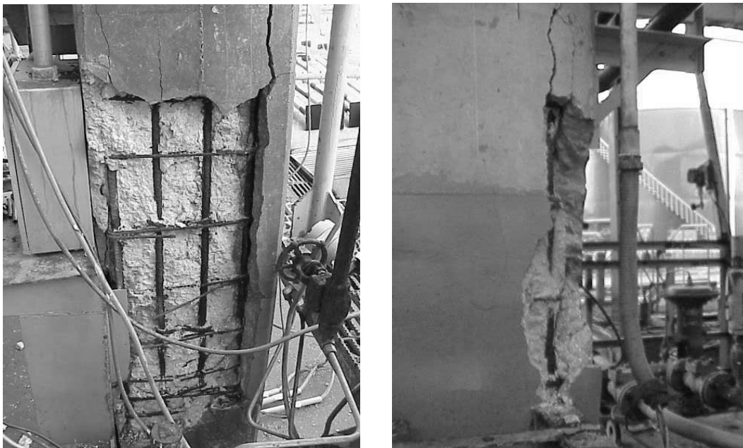
Figura 3. Deterioro Columnas. (a) Columna C6 cara oeste. (b) Columna C7 cara norte.
