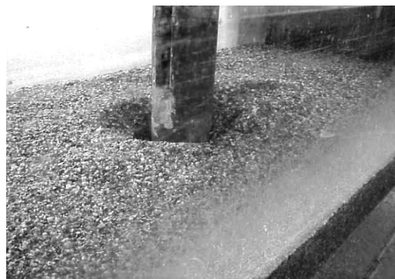
Figura 4. Foso de socavación local.
